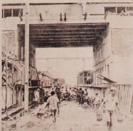
Inúmeros operários sofreram acidentes devido à falta de segurança na linha.
